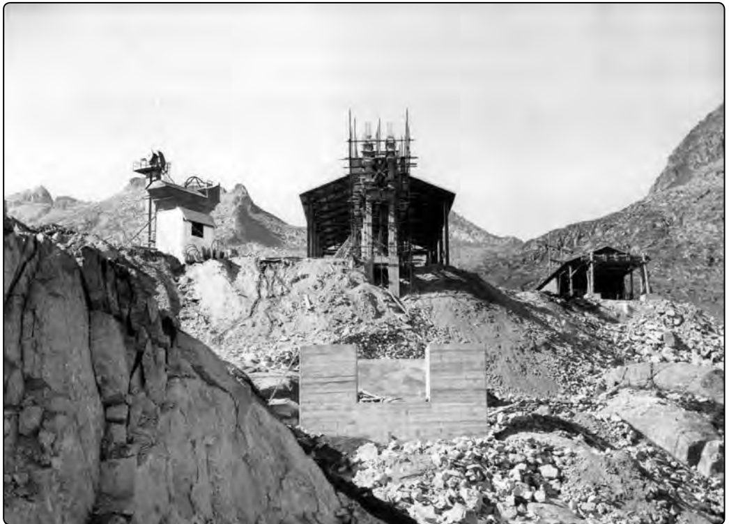
Sopra e sotto: cantiere della funivia che da Pian Nambrone saliva ai Laghetti di Cornisello
