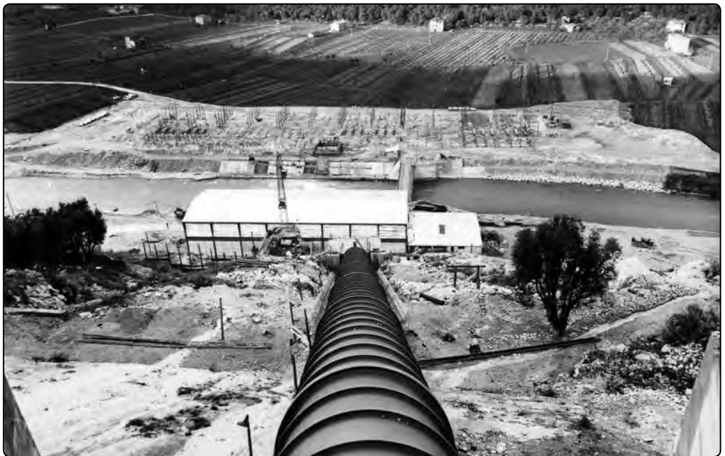
Sopra e sotto: la centrale di Torbole vista dall'alto
