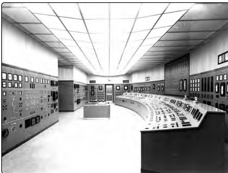
Centrale di Santa Massenza. Sala comandi
