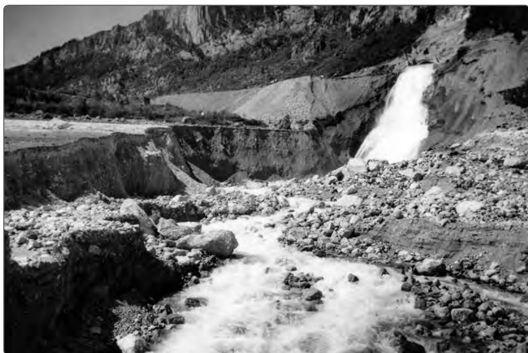
Sopra: marzo 1953. Cantiere del Lago di Molveno. Casseri e getto delle campate per il piano inclinato delle paratoie di emergenza sulle bocche di presa a quota 727.75 e 713 Sotto: 16 aprile 1953. Dalla sbocca della galleria di derivazione, una bianca e spumeggiante cascata scende nel brullo e desolato catino. In poche settimane, il Lago di Molveno rinascerà
