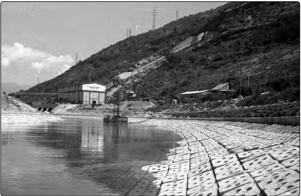
Sopra: vista dal basso della centrale di Torbole in avanzato stato di costruzione Sotto: il Sarca a valle della centrale di Torbole
